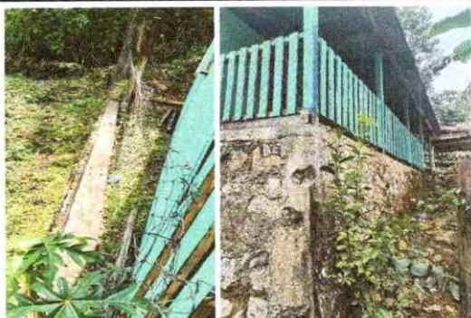
Foto 5: Deterioro del muro de la cocina
