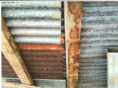
Foto 5: Techo que necesita mantenimiento
