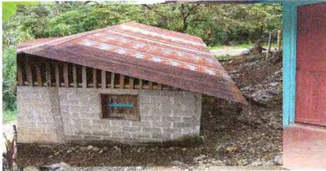
Foto 3: Edificio escolar que necesita mantenimiento.
