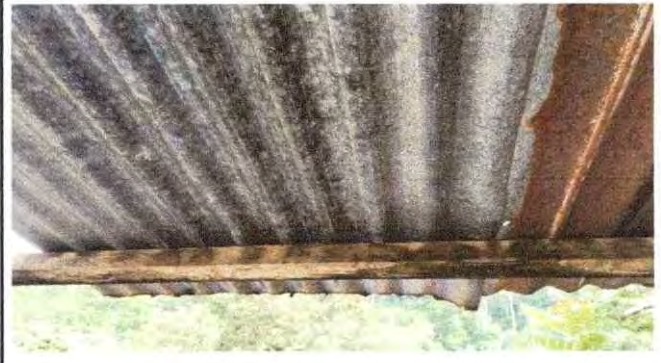
Foto 2: Láminas en deterioro y con agujeros
